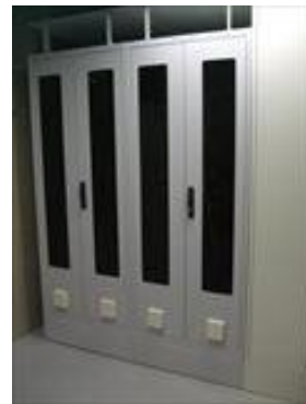
図 1 EPS 内の通信ラック
