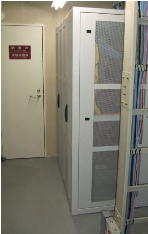
図 3 再開発後の機器設置環境
